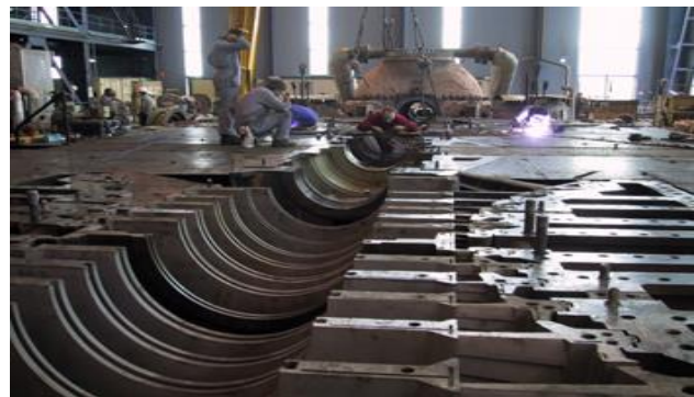
Figura 2.- Turbina abierta para mantenimiento.
